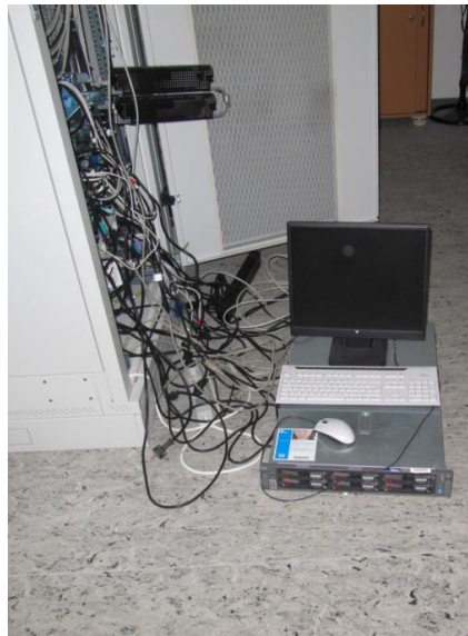
Servereinschub am Boden LASuV-Zentrale
