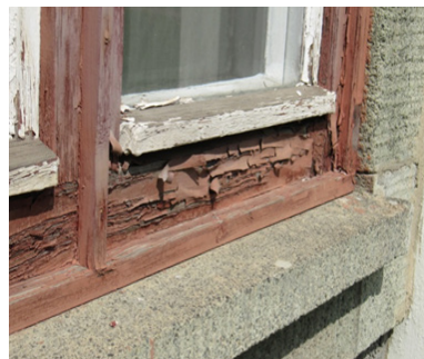
Undichte, marode Fenster
