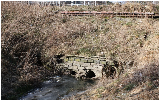
Aktueller Zustand des Durchlasses
